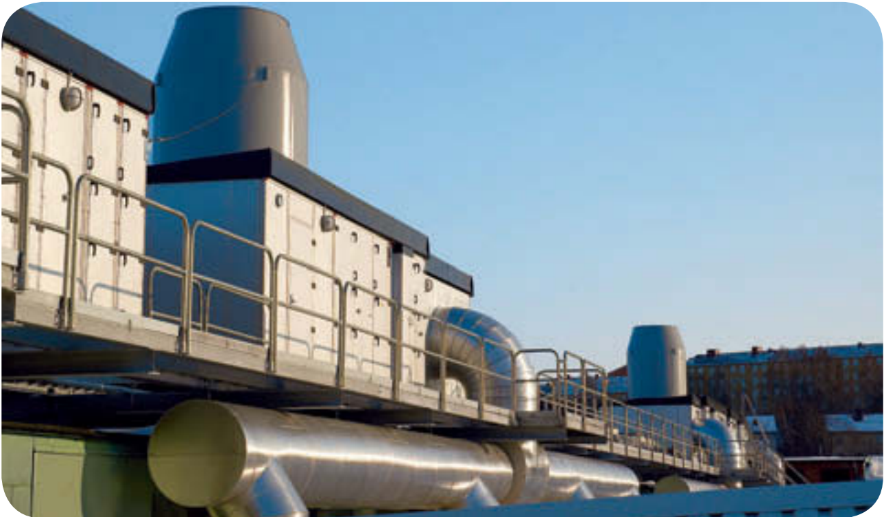
SKF Sverige i Göteborg minskade koldioxidutsläppen under 2005 genom att installera ett värmeåtervinningssystem på fabriksstaket.
